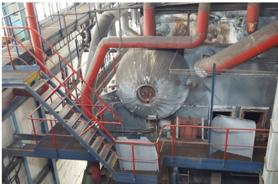
Nejnáročnější částí prací bylo demontovat horní buben starého středotlakého kotle, jehož celková hmotnost je téměř dvacet tun.
